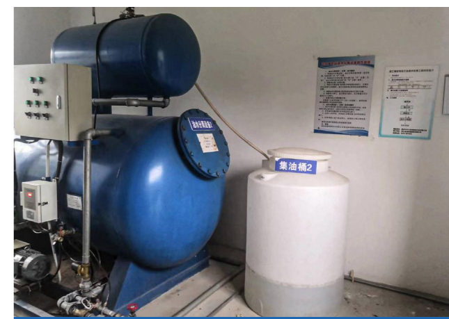
巨江航运水电站油水分离设备
